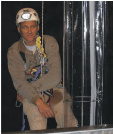
Fig. 4.2 Illustrazione della riparazione della guaina della componente NS del pendolo. A) una fase della riparazione: è stato inserito un segmento in PVC trasparente. La persona impegnata nei lavori si viene a trovare 95 m sopra il fondo della grotta. B) Una fase della riparazione della guaina. C) La guaina a riparazione ultimata.
